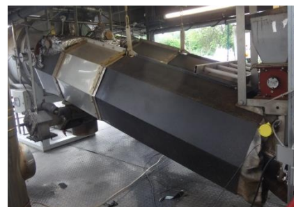
Abb. 1 Reaktoren Pyreg-Anlage Eislingen
